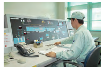
運転監視業務の様子※
